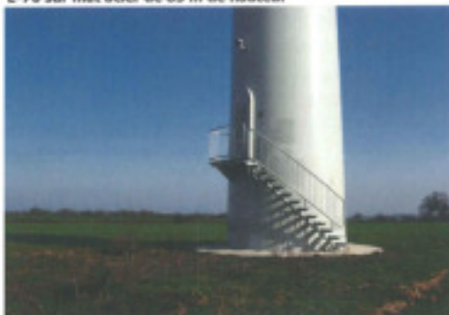
E-82 sur mât béton de 85 m de hauteur
